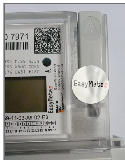
Abb. oben: Benutzersicherung für die „Spannungsbrücke“ (per Siegeletikett)
