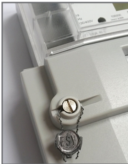
Abb. oben: Benutzersicherung für den Klemmendeckel (per Plombe)
